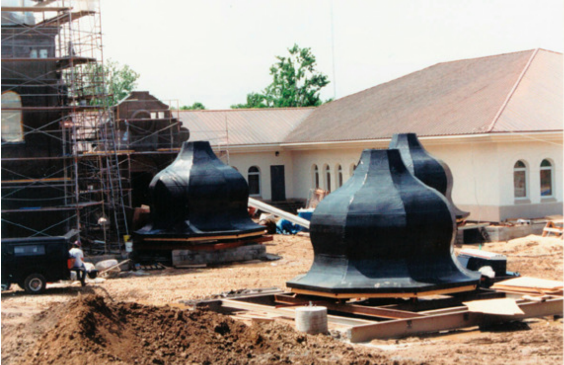
Some parts of St. Katherine Church buildings are already up, while others are ready to be finished. Деякі частини будівель Церкви Св. Катерини вже збудовані – інші ж ще вже готові до закінчення.
