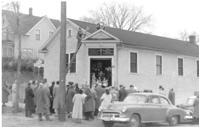
Парафіяни ставлять хрест на даху при вході до Церкви на Дженкс Авеню. Parishioners are installing the Cross on the roof of the Church Building on Jenks Avenue, St. Paul, MN
